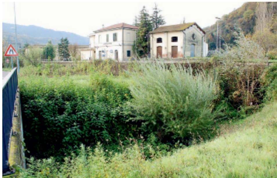
«PERICOLO» Il letto è ricoperto da arbusti, vegetazione spontanea e accumuli di terra
